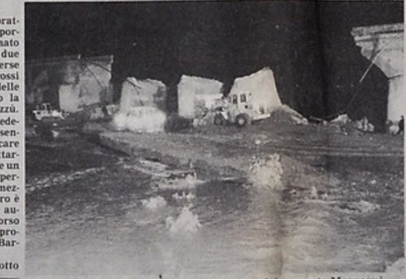
Il tratto del ponte crollato sul greto del torrente Mazzarà
